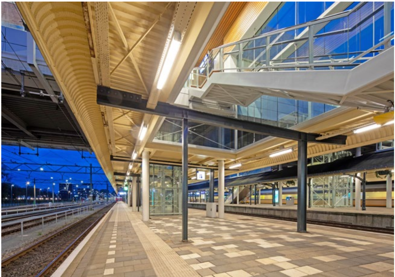
Bahnsteig 3 (die moderne Überdachung), mit dem neuen Kabelkanal in Zone C und dem alten Kanal in Zone A. Auf dem alten Kanal sind an den Positionen der alten Leuchten noch schlecht lackierte Stellen zu sehen. Diese Stellen wurden inzwischen lackiert.
