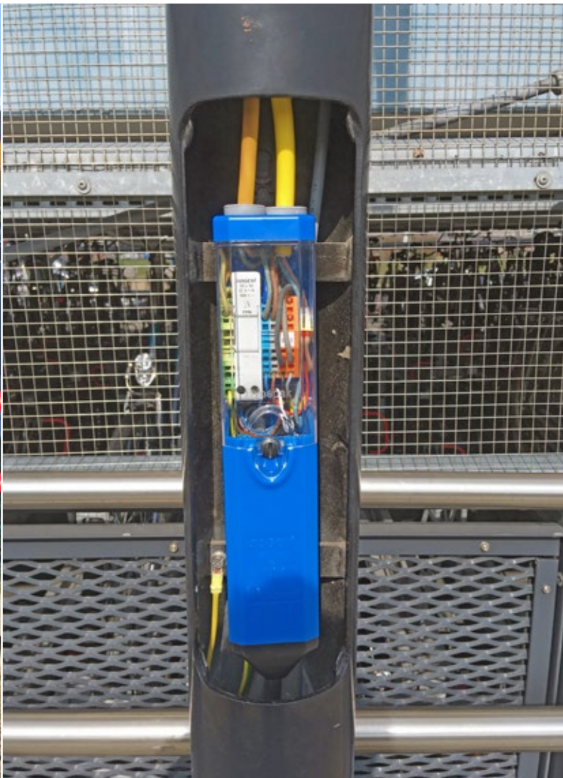
Sogexi berührungssicherer geschlossener Verteilerkasten im Bahnhof Oss.
