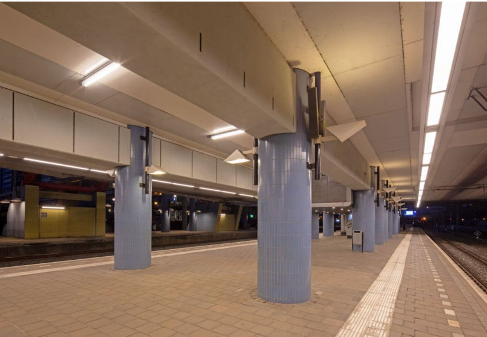
LED-Beleuchtung im Bahnhof Amsterdam Sloterdijk
