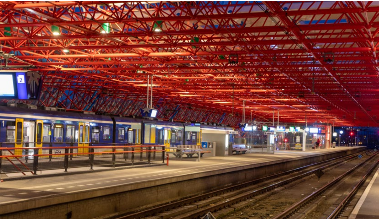
Oben das spärliche Licht auf einem Bahnsteig im Bahnhof Almere Centrum im Jahr 2016. Unter der neuen Situation mit viel höherer Beleuchtungsstärke und besserer Gleichmäßigkeit.
