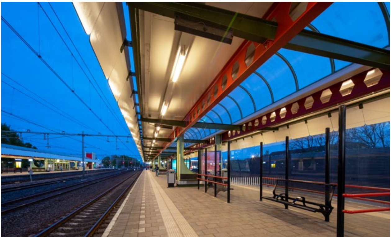
Bahnhof Weesp. LED-Lampen geben ein wärmeres Licht ab als Leuchtstoffröhren, wodurch es sich auf Bahnhöfen angenehmer anfühlt. Die Lichtlinie wurde nach innen verlegt, wodurch die Mitte des Bahnsteigs weniger düster wirkt. In Weesp wandte der Architekt in den 1970er Jahren ebenfalls die Regel „Tageslicht, es sei denn“, indem er den mittleren Teil der Überdachung transparent gestaltete.
