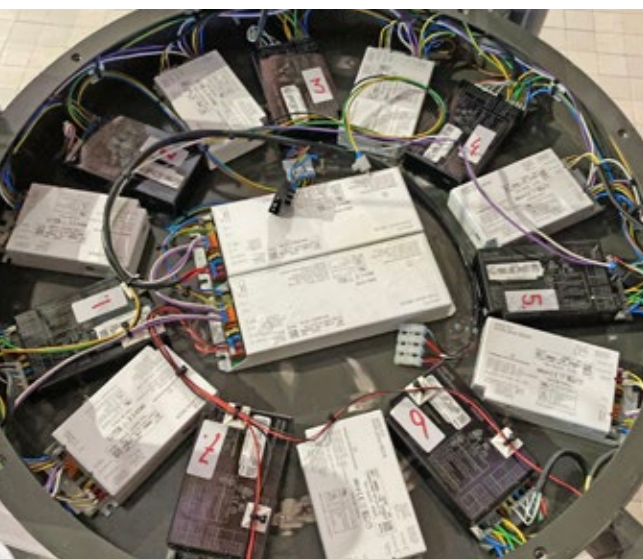
16 Treiber im Kronleuchter. Die 2 x 100 W TW Treiber in der Mitte befinden sich jetzt außerhalb der Leuchte auf dem Dachboden.
