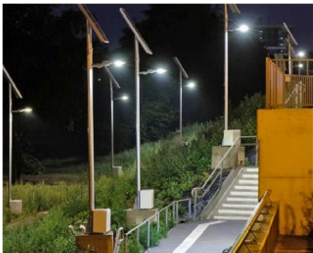
Provisorische Solarmasten entlang der Treppe und der alten Rampe des Bahnhofs Blerick.
