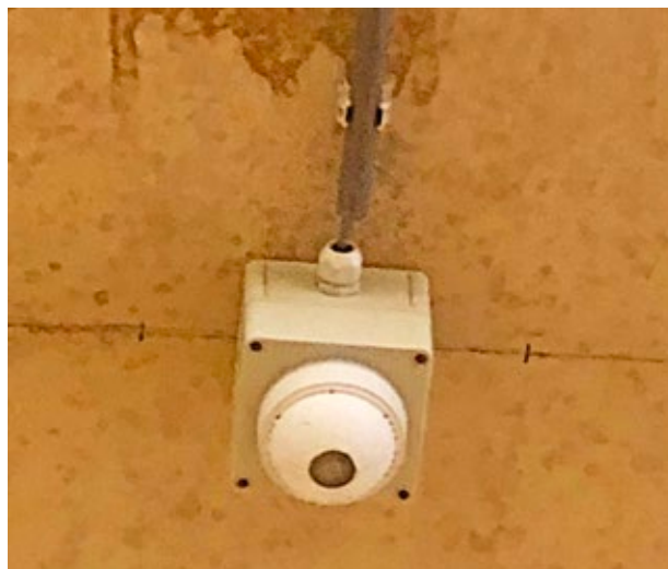
Die Sensoren, die alle 30 m über dem Bahnsteig installiert sind
