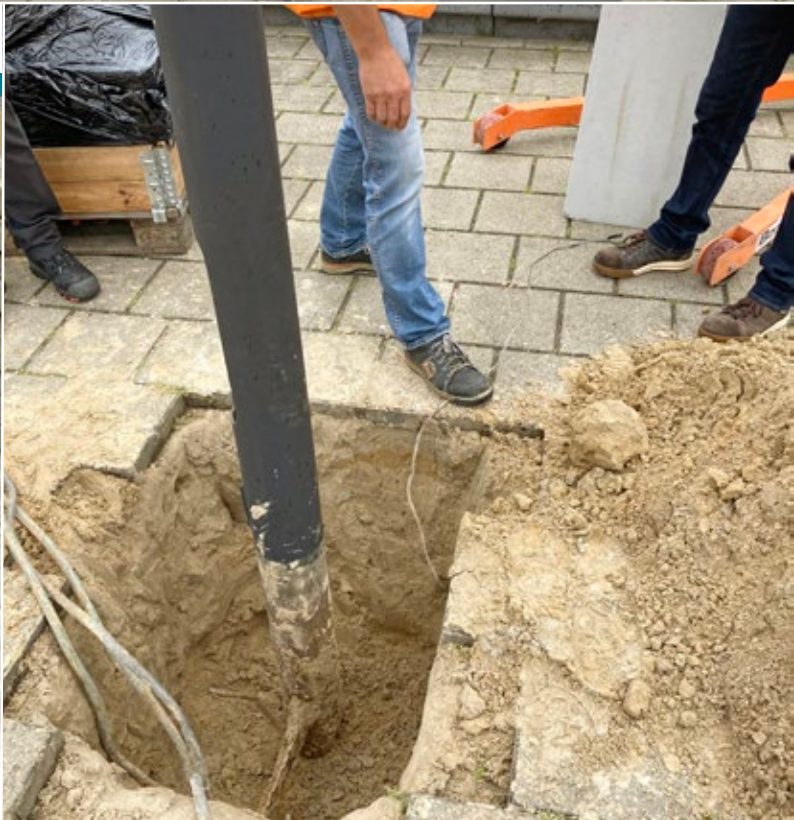
Das alte Kabel wurde am alten Mast aufgerissen.
