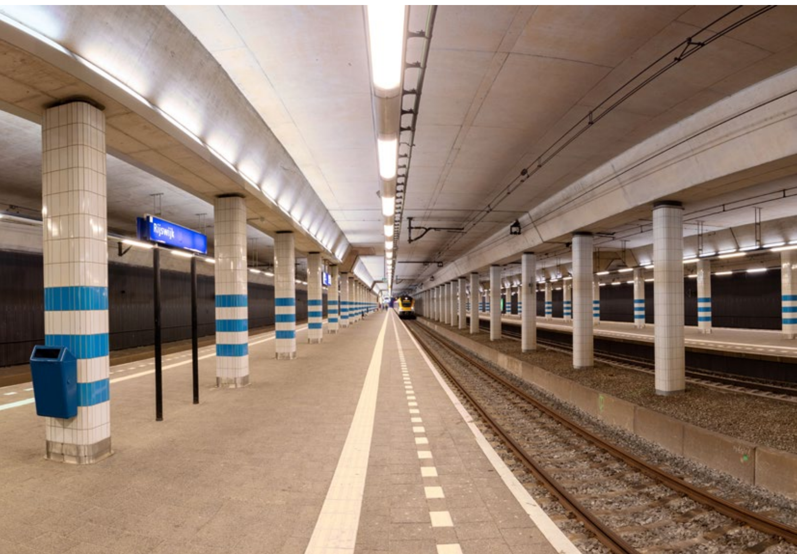
Uplight Kaltweiß und Downlight Warmweiß auf den beiden mittleren Bahnsteigen des Bahnhofs Rijswijk.
