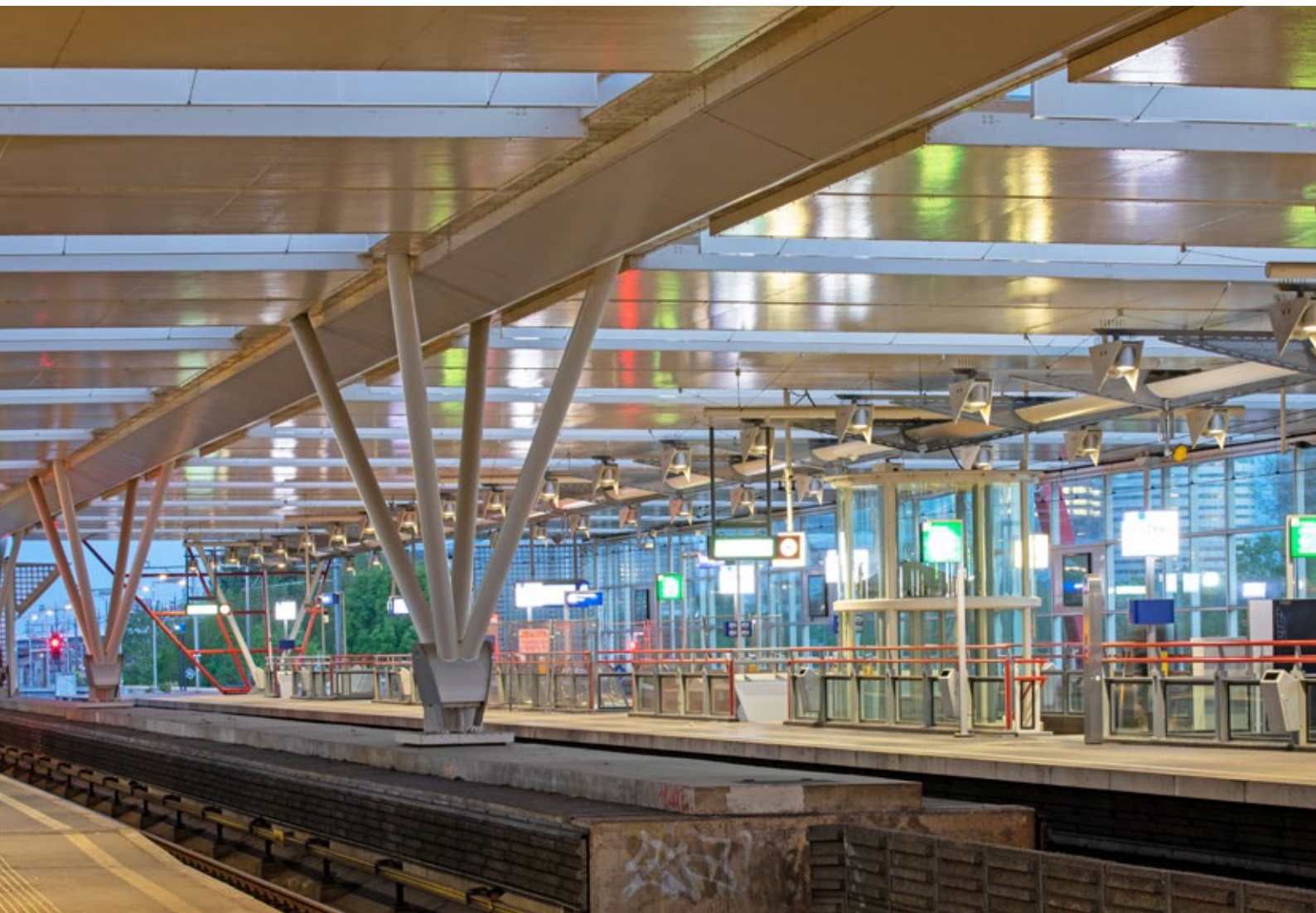
Die Strahler zwischen den Dreiecken wurden mit einem neuen LED-Innenleben ausgestattet.
