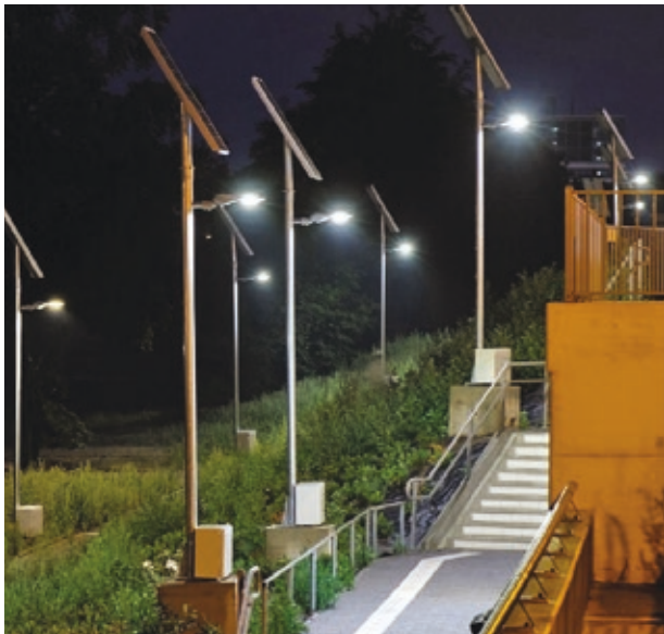
Tijdelijke solar masten langs de trap en oude hellingbaan van station Blerick.
