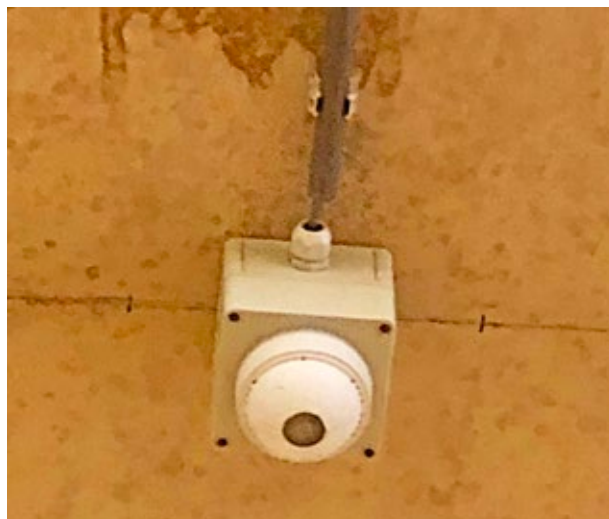
De sensoren die elke 30m boven het perron zijn aangebracht
