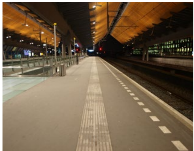
De situatie voor de led vervanging. Een groot deel van de uplighters was defect.
