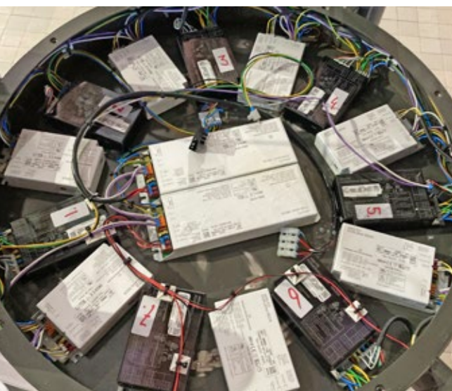
16 drivers in de kroonluchter. De 2 x 100W TW-drivers in het midden zijn nu buiten het armatuur op zolder geplaatst.
