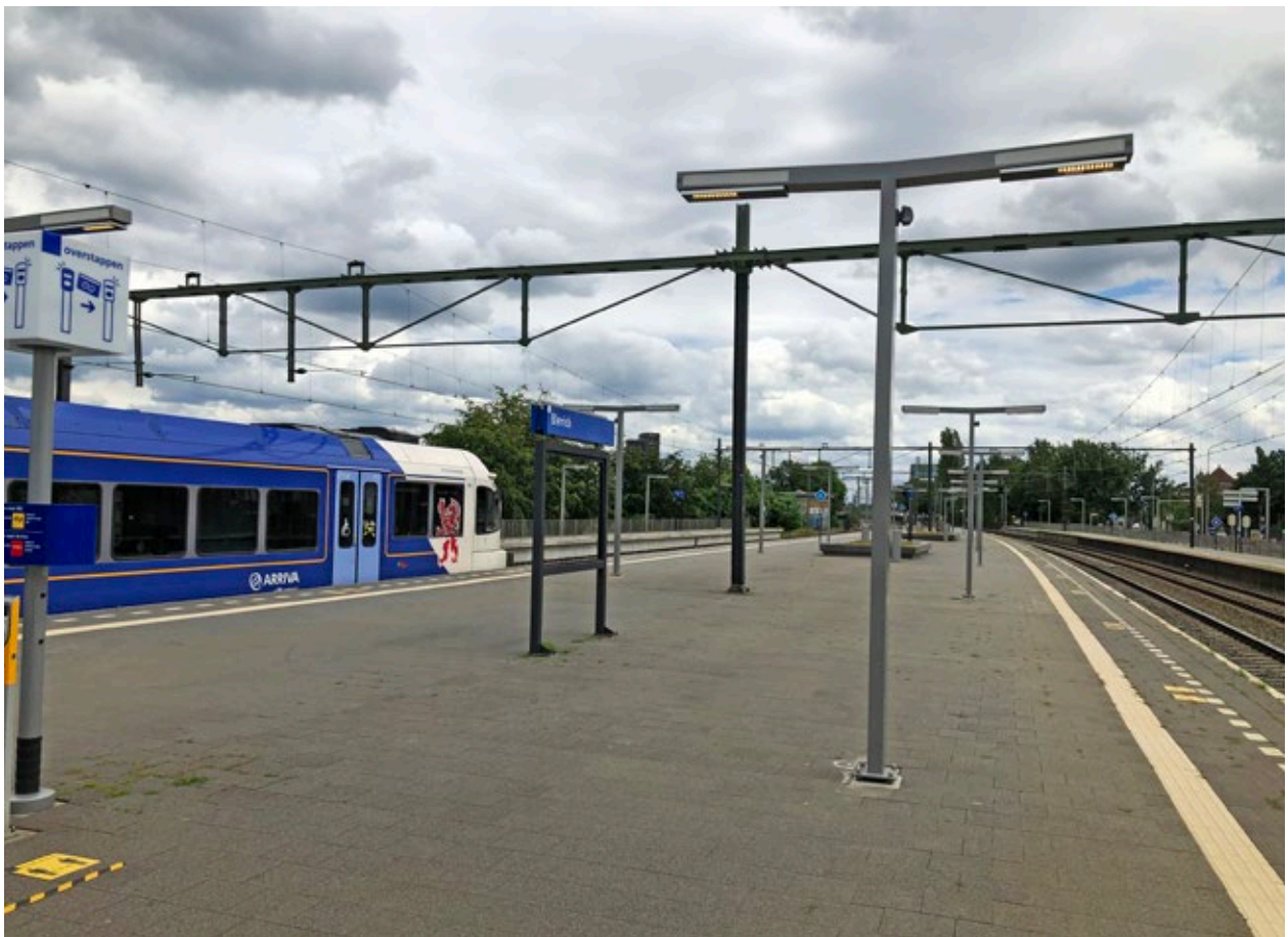
Bij de eind oplevering in juni 2020 zijn de grijze dimsensoren wel geplaatst. Hierboven zie je steeds 2 luidsprekers in een mast met dubbele uithouder. Op basis van voortschrijdend inzicht zouden we nu een luidspreker per mast, aan de spoorzijde, toepassen.
