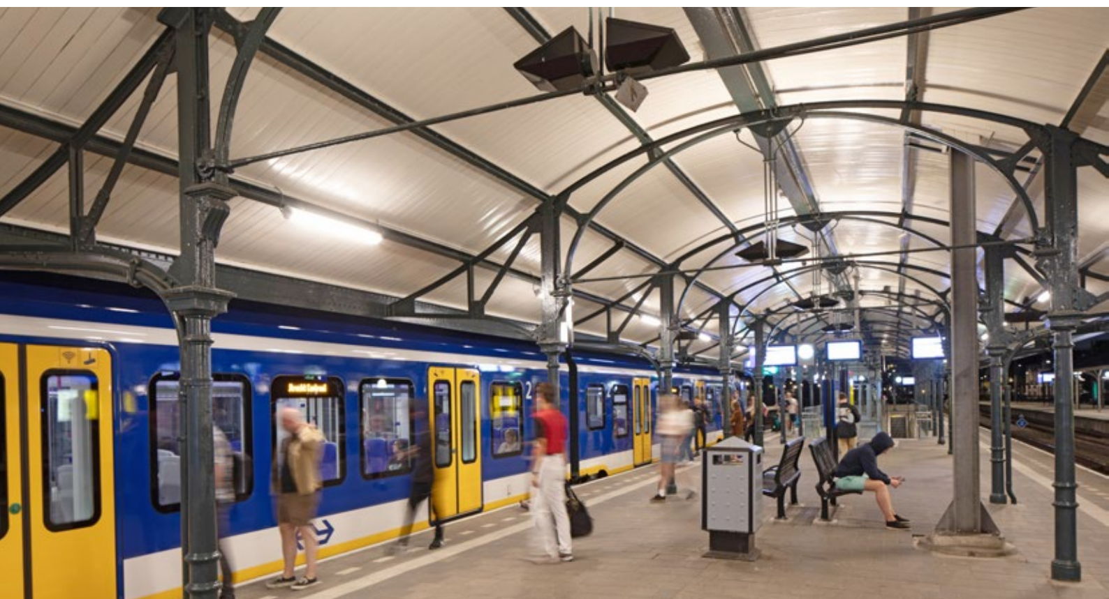
Nieuwe uplighters onder de kap op station Hilversum met schuine ruit waar duiven afglijden. Aan de zijkant van de kap zijn de toegevoegde armaturen boven de geleidelijn te zien.
