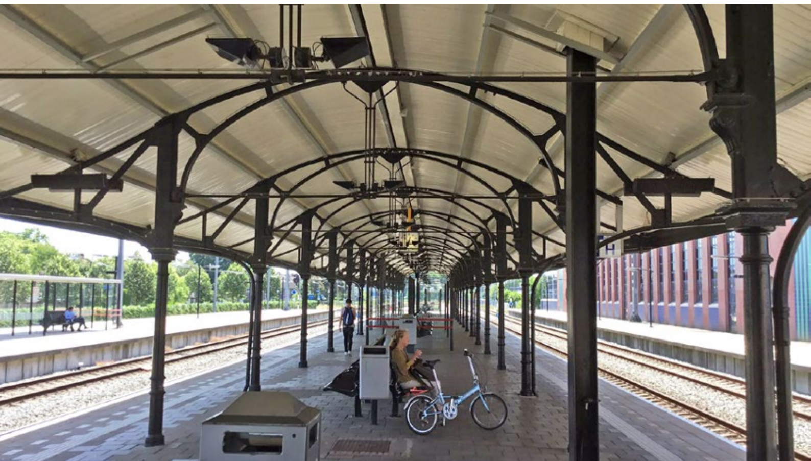
De oude uplighters op station Hilversum met horizontale ruit en anti duiven schrikdraad installatie.
