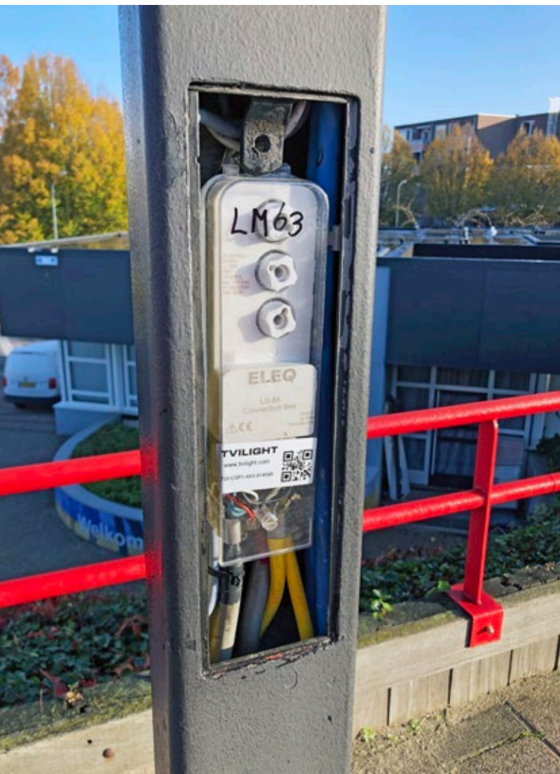
Eleg aanraak veilige spatwater dichte aansluitkast in mast op Helmond.
