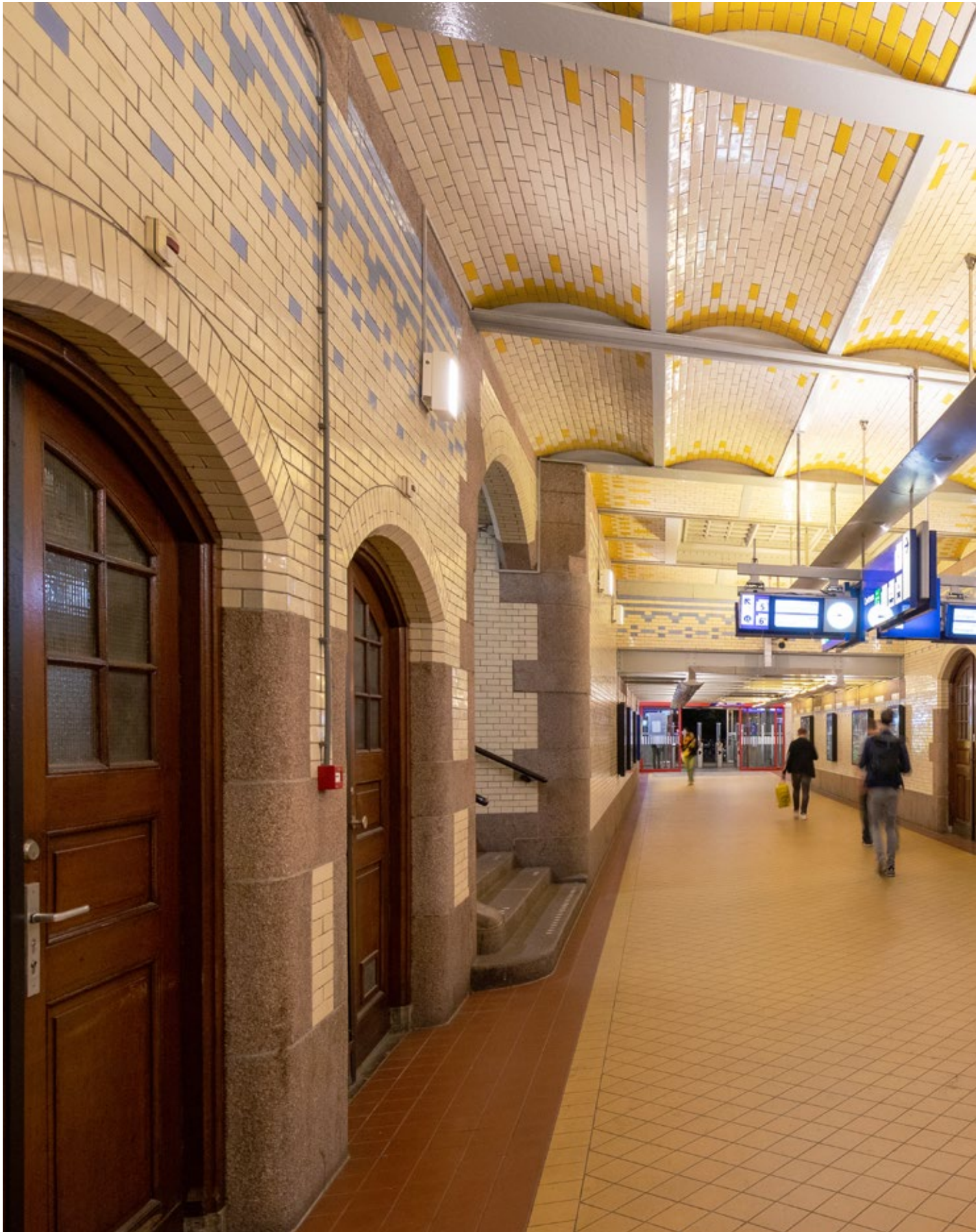
Indirecte led verlichting in de reizigerstunnel maakt het bijzondere metselwerk en de tegels mooi zichtbaar (hier was de verlichting al wel vervangen door led).
