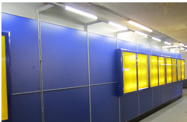
1. Toepassing van TL-verlichting met kabelgoot, Amsterdam Centraal Station.
