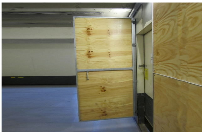
3. Toepassing van een deur in een frame, ten behoeve van een doorgang op Amsterdam Centraal.
