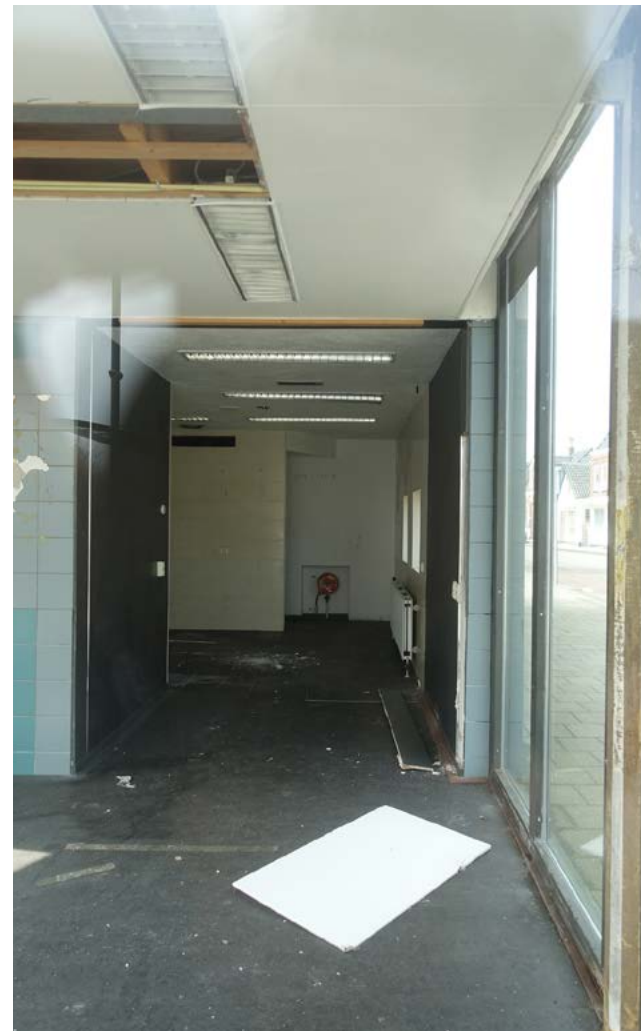
Doorzicht vanuit de wachtkamer naar de personeelsruimte. Hier was voorheen de balie geïnstalleerd, het was niet mogelijk om door te lopen, het personeelsgedeelte had een eigen ingang.
