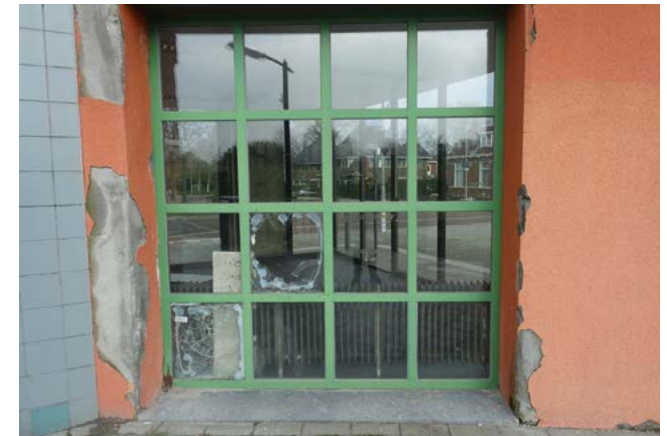
Raamwerk in de achterkant van de muur, ter hoogte van de wachtkamer.
