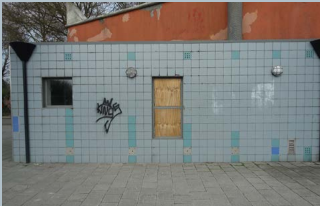
Slechte staat van onderhoud, waardoor de speelsheid, het kleurgebruik en de heldere soberheid van het gebouw niet meer tot hun recht komen. De verandering in kleur en afwerking van de muur werkt hier niet ten positieve.
