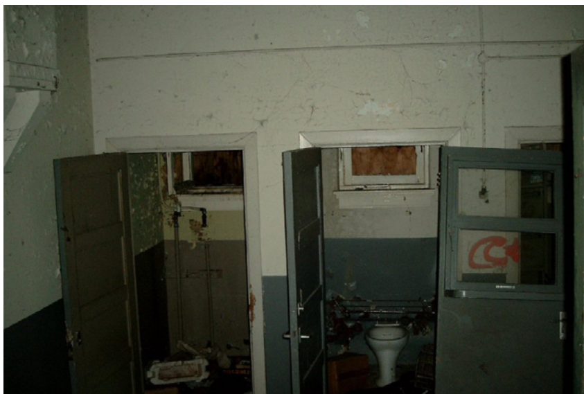
Afb. 2.4.8 De sanitaire voorzieningen in vervallen staat in 2003. Coll. HSA
