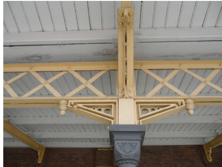
Afb. 5.2.20 De decoratie van de gietijzeren staanders onder de perronkap. Aan het bovenliggende houtwerk zichtbaar dat de kap een onderhoudsbeurt nodig heeft.
