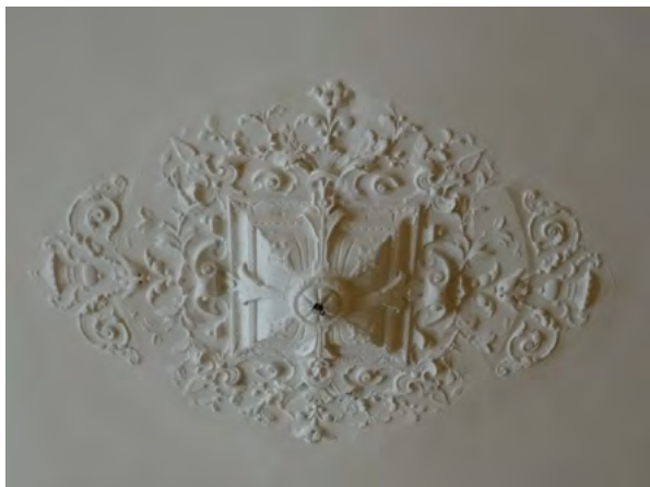
Afb. 5.25 Het centrale stucornament in het plafond van de wachtkamer (2e Klasse). Bij de modernisering van 1958-59 zijn geen verlaagde plafonds ingebracht, waardoor de originele stucplafonds onbeschadigd bewaard zijn gebleven.
