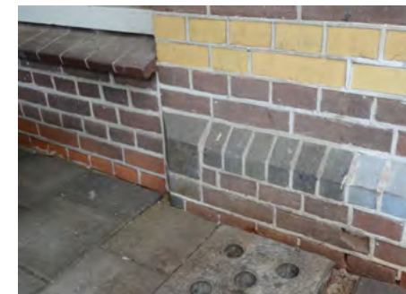
Afb. 5.12 Links het afwijkende metselwerk van de plint onder het venster dat een perrondeur vervangt.
