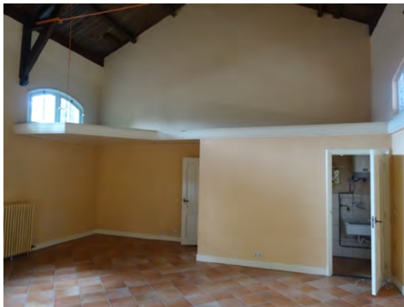
Afb. 5.20 De goederenvleugel. In 1959 zijn alle muren uitgebroken. Na 1973 is een toilet en washok ingebouwd. De vloerbekleding dateert uit die periode.
