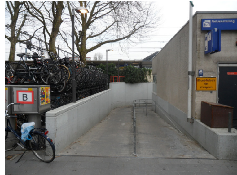
Afb. 5.5.7 De betonnen westgevel van het stationsgebouw, met de hellingbaan naar de reizigerstunnel.
