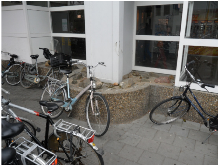
Afb. 5.5.18 De afwerking van de pilaster-voeten met plantenbakken van grindbeton, die doorlopen als plint onder de ramen langs.
