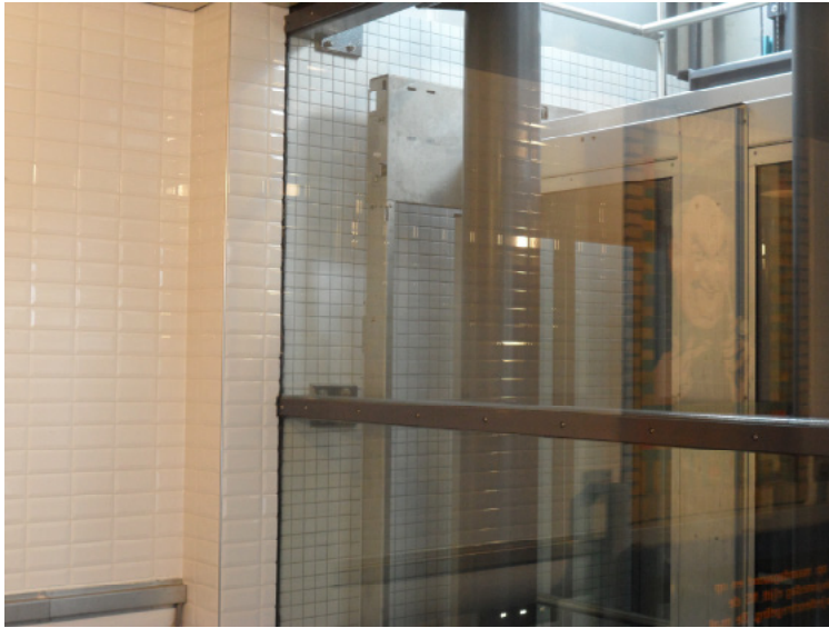
Afb. 5.6.7 Bij de nieuwe liftschacht is de wand bekleed met klein vierkant tegelwerk.
