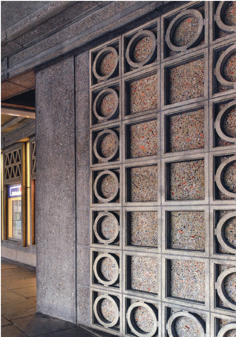
Station Enschede, detail in oostfaçade waarin toeslagstoffen goed te zien zijn
