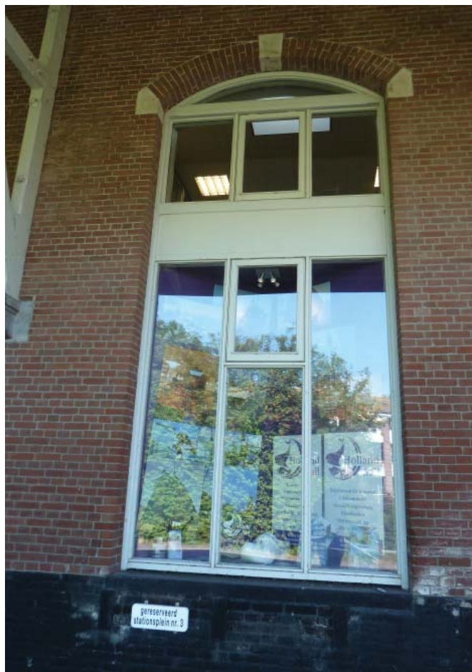
(afb. 129) de nieuwe vensters van goederenloods zijn niet passend
