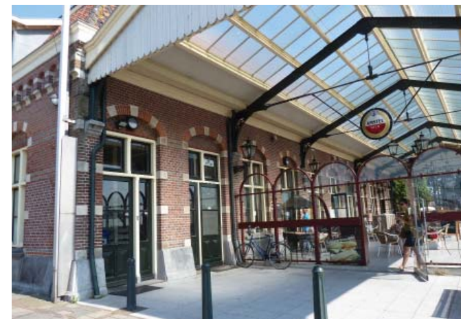
(afb. 126) de terrasomheining van de zuidelijke overkapping is niet passend en de relatie tussen de kap en de spanten is niet meer aanwezig
