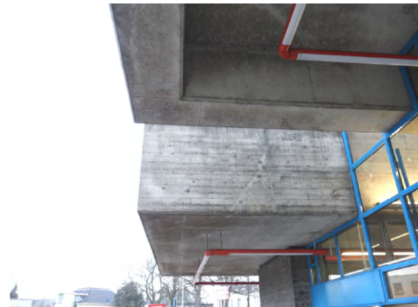
Afb. 4.6 De doorlopende verlichtingselementen aan de buitenzijde van de westgevel.
