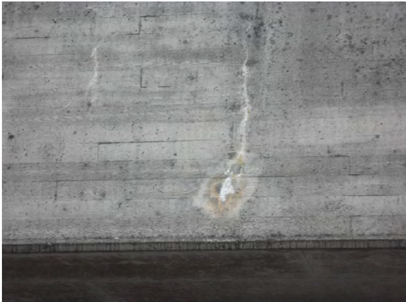
Afb. 4.5 Beschadiging aan de dakrand boven het plaatskaartenkantoor.
