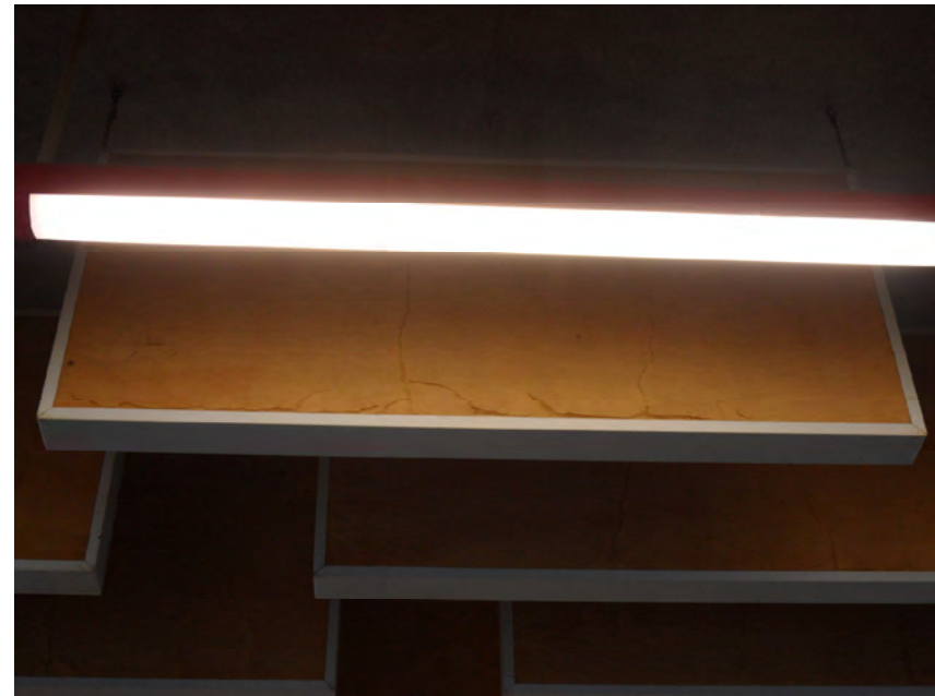
Afb. 4.17 De slechte conditie van diverse platen is opvallend zichtbaar.
