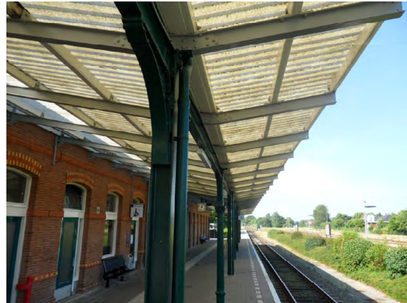
Afb. 5.2.11 De afwijkende zuil van I-profiel onder de perronkap te Delfzijl, met hemelwaterafvoer. De kap is bedekt met lichtdoorlatende golfplaat.
