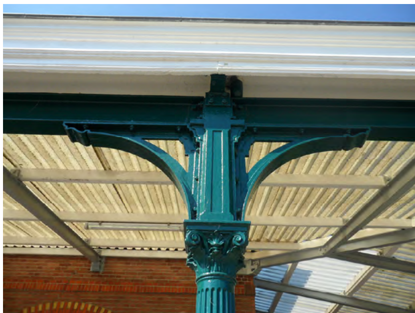
Afb. 5.2.8 Een originele gietijzeren zuil, met Korintisch kapiteel. Daarboven aan weerszijden de twee korbelen die draagbalk steunen.
