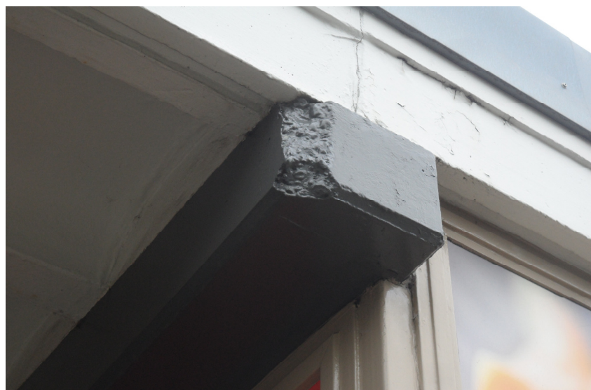
Afb. 5.18 Overschilderde beschadiging aan de perronzijde van het tweede betonportaal.
