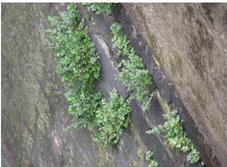
Muurvaren op een oude kerkmuur
